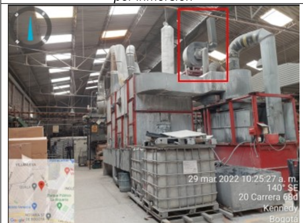
Fotografía No. 7. Centrífuga y ducto de descargas
