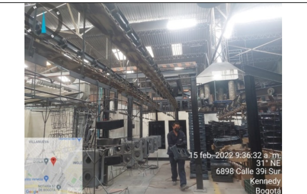
Fotografía No. 10. Horno TKF y ducto del horno TKF
