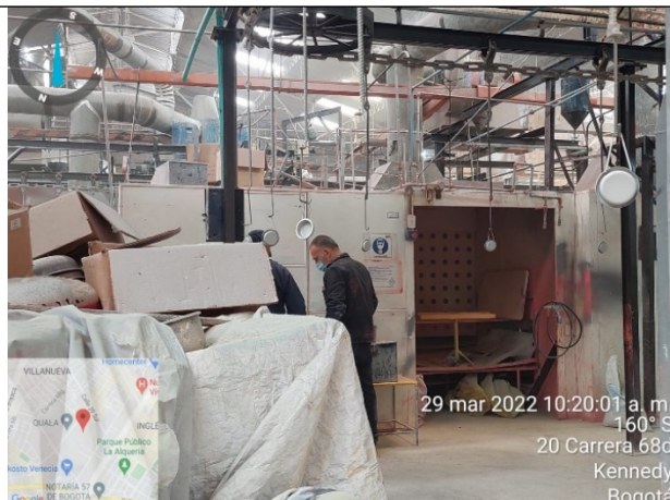
Fotografía No. 6. Cabinas de pintura No. 1
